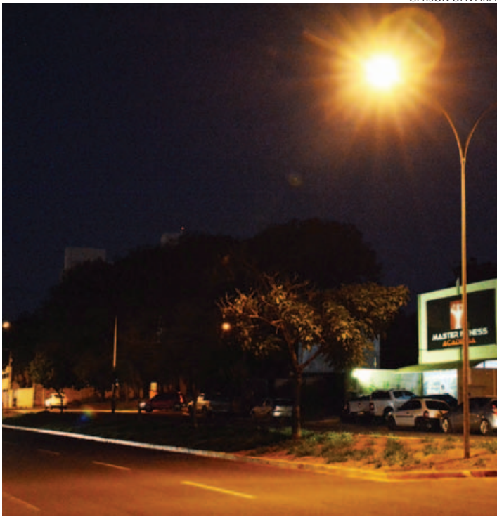
SEM LUZ. Postes na Avenida Interlagos estão estragados
