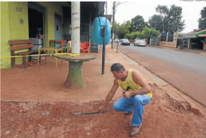
LONGA ESPERA. Vilarim Prestes precisou pagar por ligação de esgoto que tem até 2020 para ser instalada, e ainda foi multado
