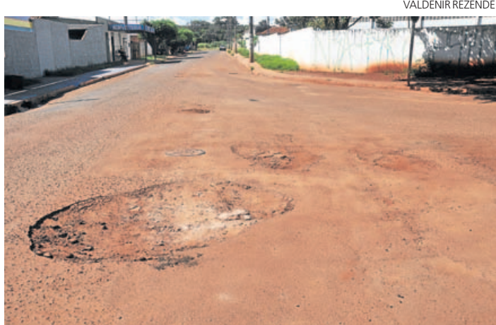
ROUXINÓIS. Rua Querubina Garcia está repleta de buracos
