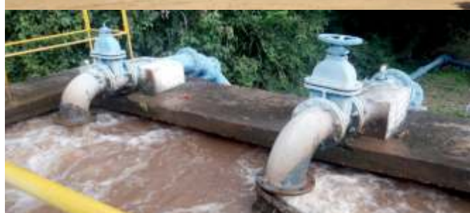
30 e 31/03 - Estação de Tratamento e Captação de Água do município de Aquidauana - MS.
