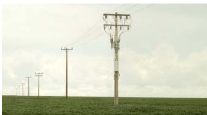
Rede de Distribuição Compacta e Protegida Alimentador 138 kV - Cassilândia
