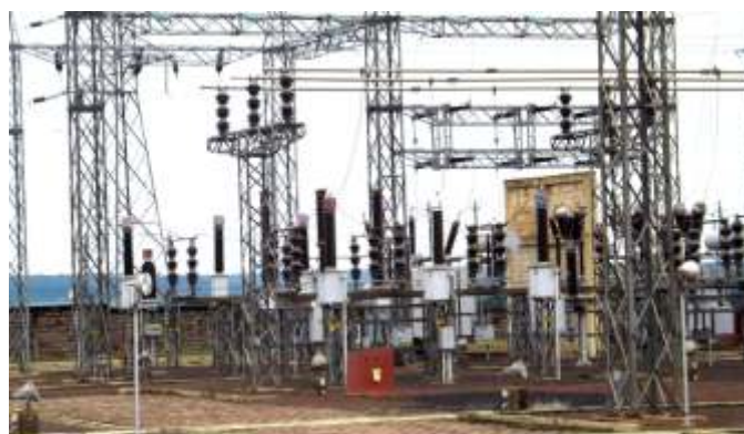
Subestação de Energia - Cassilândia
